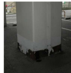
図-1 地際部の柱の腐食状況
