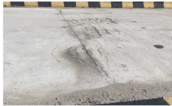
図-3 コンクリート橋上面の損傷
