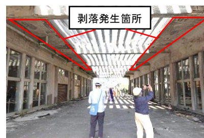
b) 底下部のコンクリート剥落の様子
