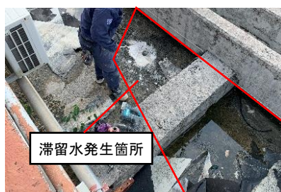
a) 底上部の滞留水の様子
