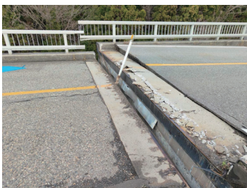
写真-1 路面に段差が生じた被災事例 1)
