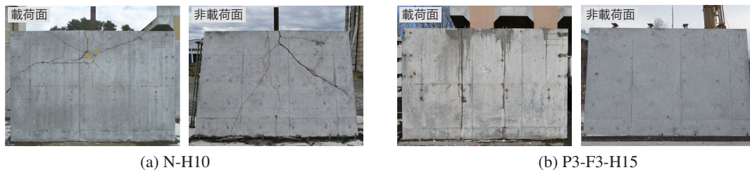
写真-3 実験終了後における擁壁の載荷面および非載荷面に関する損傷状況
