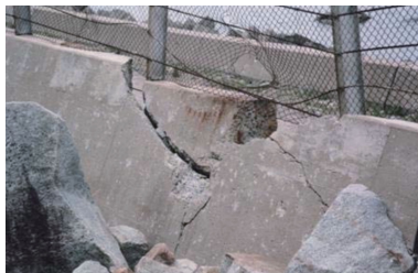
図-1 落石防護擁壁の損傷事例
