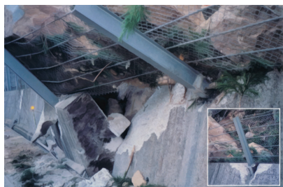
写真-1 擁壁の支柱基部近傍部における損傷例
