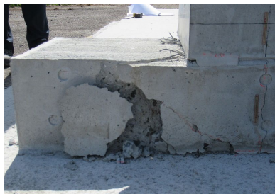
写真-5 端部供試体コンクリート剥離状況
