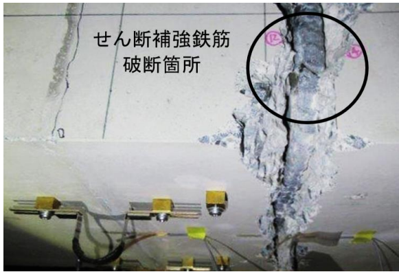
写真-4 試験体 No. 2 せん断補強鉄筋破断状況 (繰返し曲げ載荷試験 Step17 終了時)
