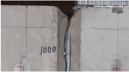
写真-3 Case5 接合面ひび割れ状況 (1000kN 時)
