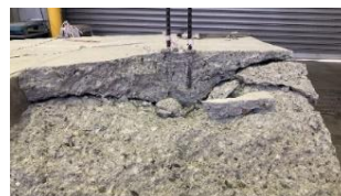
写真-3 試験体損傷状況 (No.3-1)
