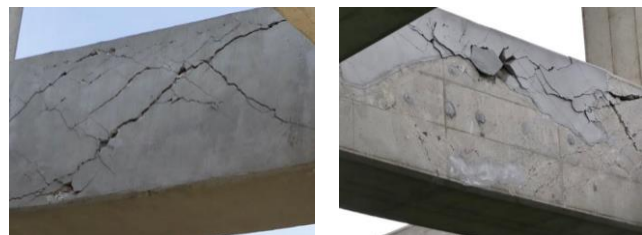
写真-1 福島県沖地震の被害事例(2021 年)
