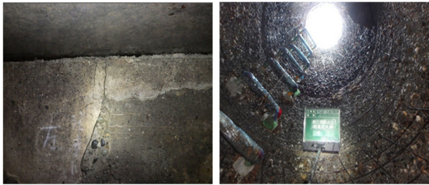
(1) マンホール継手部の (2) 硫化水素による表面腐食 ひび割れ損傷
