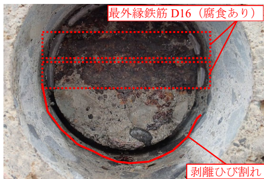
写真-5 鉄筋の腐食状態 (A-1)
