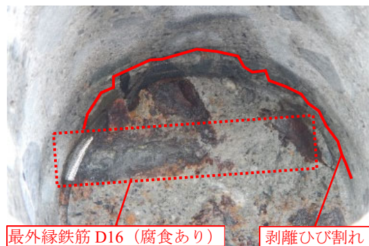
写真-7 鉄筋の腐食状態 (A-2f)
