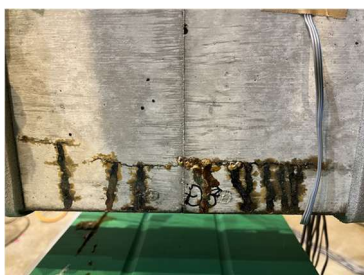
写真-2 電食範囲の外観（腐食率 1 %）
