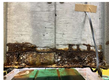
写真-3 電食範囲の外観（腐食率 10%）
