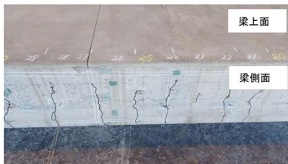
写真-2 試験体中央付近のひび割れの状況
