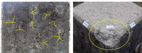
写真-5 ひび割れ状況
