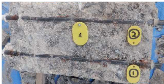
鉄筋 1・2 (錆び落とし有り), 表面側, グレード 1
