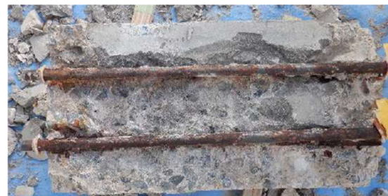
鉄筋 3・4 (錆び落し無し), 内部側, グレード 3
