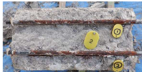
鉄筋 1・2 (錆び落し無し), 内部側, グレード 3
