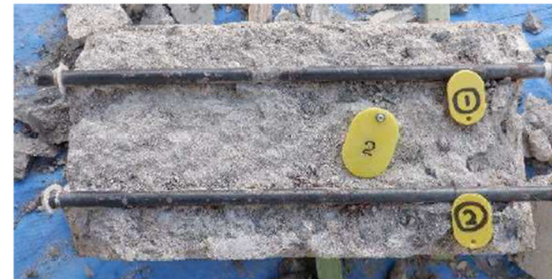
鉄筋 1・2 (錆び落し有り), 表面側, グレード 1
