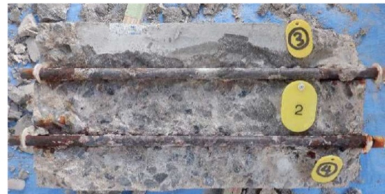
鉄筋 3・4 (錆び落し無し), 表面側, グレード 2
