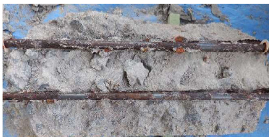
鉄筋 3・4 (錆び落とし無し), 表面側, グレード 3
