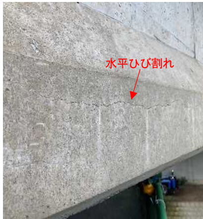
写真-5 ポステン PC・T 桁に発生したひび割れ（耳フランジ下部の水平ひび割れ）
