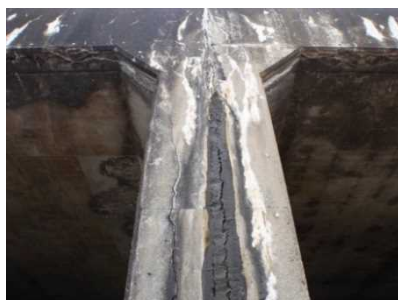
写真-2 ASR により深刻な劣化が発生した RC 橋梁
