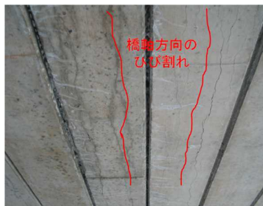
写真-3 プレテン PC ホロー桁下フランジに発生した ASR ひび割れ
