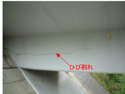
写真-6 桁端部に発生した部材断面貫通ひび割れ
