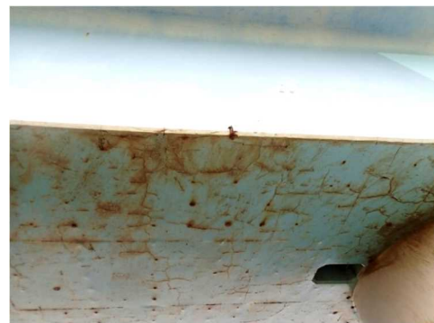
写真-7 PC 箱桁表面に発生した乾燥収縮によるひび割れ
