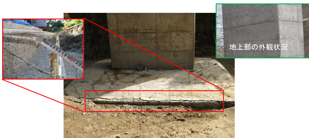
写真-1 ASR が発生したフーチングの劣化状況
