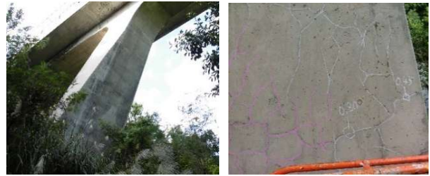
写真-1 K橋 P2橋脚の劣化状況
