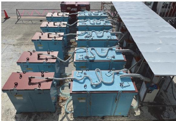
写真-2 高濃度 CO 2 ガス循環方式の設備外観
