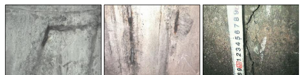
(1) 鉄筋の腐食 (2) ひび割れと腐食 (3) ひび割れ 写真-1 下水道マンホールの直壁の損傷状況
