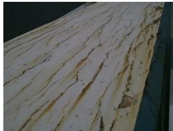
図-5 弾性エポキシ樹脂系塗膜の損傷 (桁下面のひび割れと析出物の状況)
