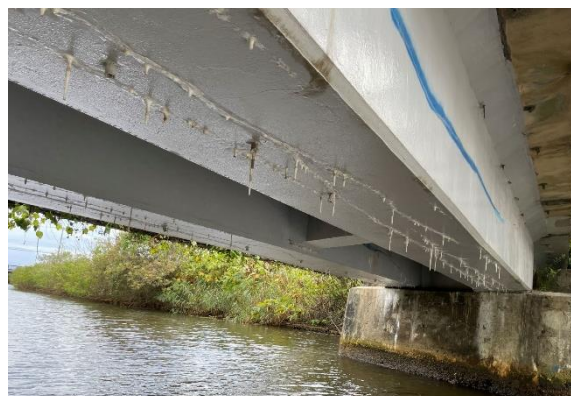
図-3 ゴムアスファルト系塗膜の状況 (桁下面のひび割れと析出物の状況)
