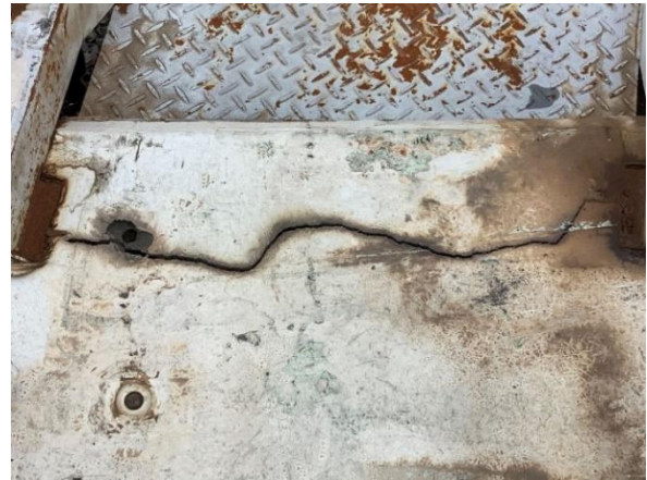
図-4 アクリルゴム系塗膜の損傷 (桁下面のひび割れと析出物の状況)
