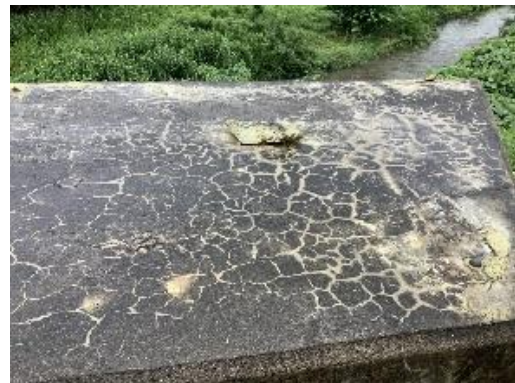
図-2 ポリウレタ樹脂系塗膜の損傷 (塗膜の消失とコンクリートのひび割れ)
