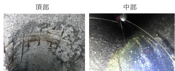
写真-3 煙突内部劣化状況
