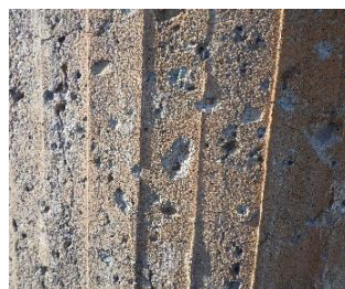
写真－8 表層スケーリングの様子
