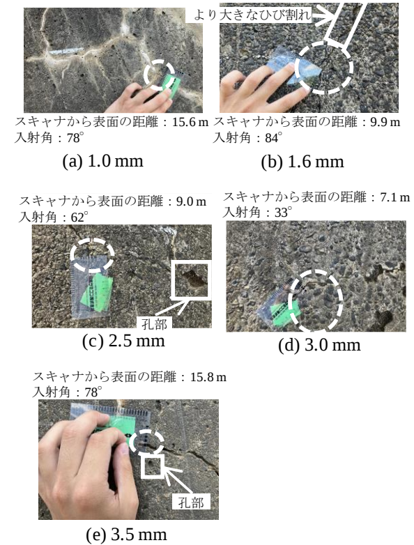
図-1 ひび割れ部の可視画像
