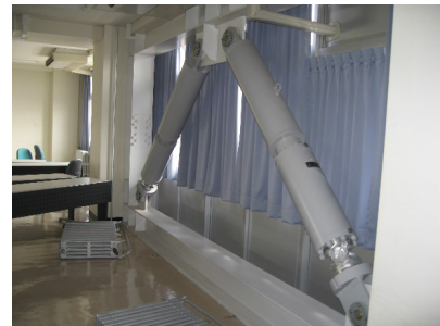
写真-5 建物に設置された オイルダンパー（2005年）
