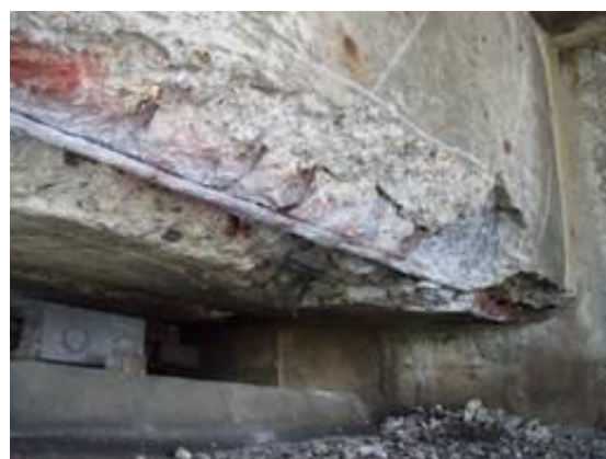
写真-2 道路橋の支承周辺部での塩害劣化
