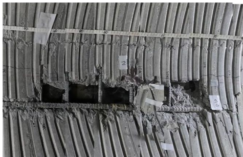
図－7 30W の破壊部の上床版下面の状況
