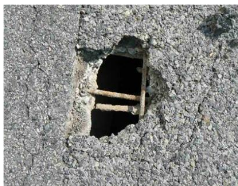
写真-1 床版抜け落ち事例
