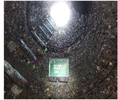
(3) 硫化水素による腐食
