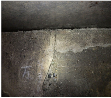
(1) ひび割れ損傷
