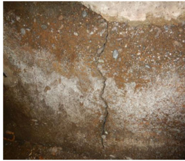
(2) 補修後のひび割れ損傷
