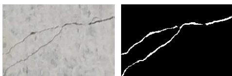
図-11 ひび割れの分岐 (左: 写真, 右: 二値画像)
