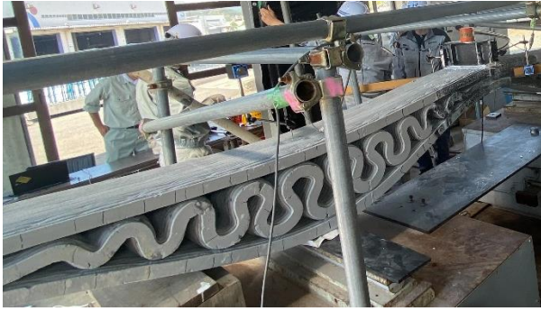
図-17 試験体 No. 1 の層間接着不良箇所
