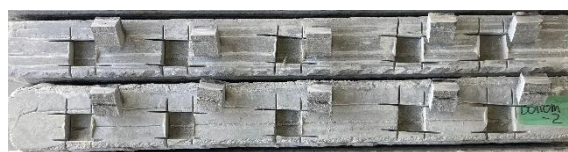
写真-10 剥離した界面の状況
