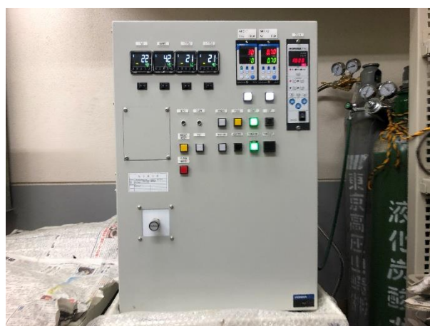
写真-2 ガス濃度制御装置
