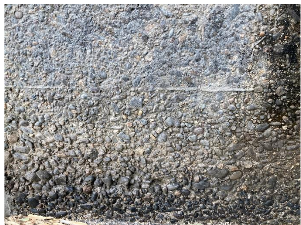
図-1 安積疎水水路の側面の劣化状況
