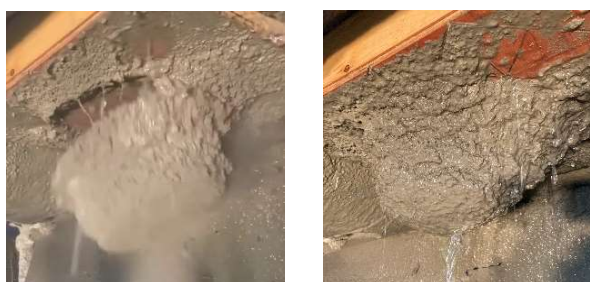
写真-20 (a) 剥落時 (b) 吹付け終了時 天端への吹付け (φ3mm×13 穴, W/C35%)
