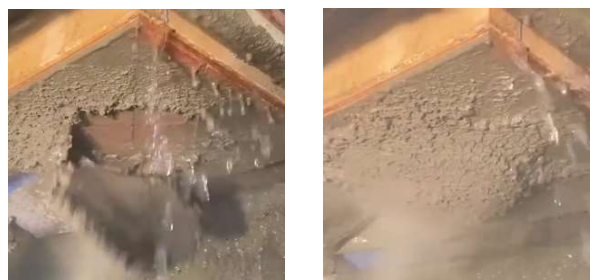
写真-19 (a) 剥落時 (b) 吹付け終了時 天端への吹付け (φ3mm×13 穴, W/C40%)
