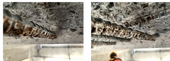
かぶり 15 mm かぶり 27 mm 写真-6 かぶりの異なる鉄筋の腐食状態
