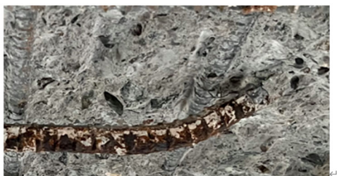
写真-7 曲げ上げ部の腐食状態
