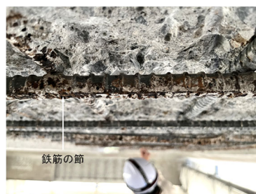
写真-8 節が斜めの鉄筋の腐食状態
