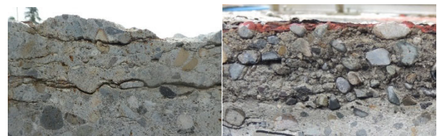
図-2 土砂化部直下における床版断面の例
