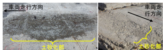
(a)Ki 橋 (b)Ka 橋 図-1 アスファルト舗装の開削後にセンターライン付近で確認された RC 床版上面の土砂化
