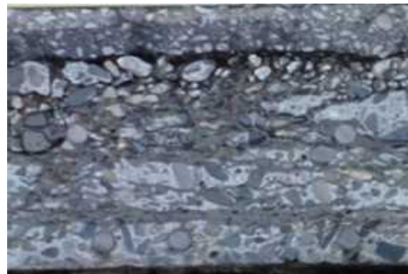
写真-2 寒冷地の床版で生じた層状ひび割れや土砂化 2)
