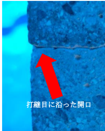
図-9 供試体 2 の端部での打継目に沿った開口 (写真は供試体の長手方向から撮影)
