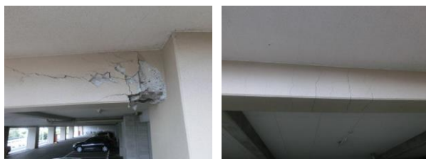
写真-3 L 構面 2 階梁端部
