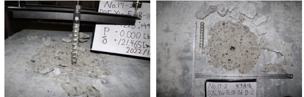
付着破壊 (定着部: 片側破断) No.17-2 D25_Yio-Fc18-8d-B-2
