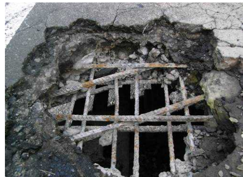
写真-1 RC 床版の押抜きせん断破壊
