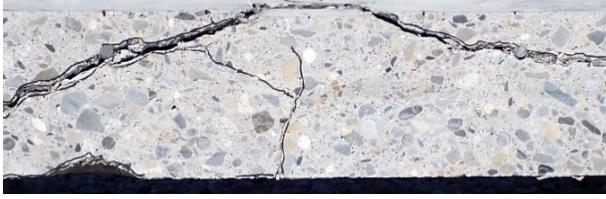
写真-4 載荷点近傍のひび割れ状況 (供試体-2: 橋軸直角方向断面)
