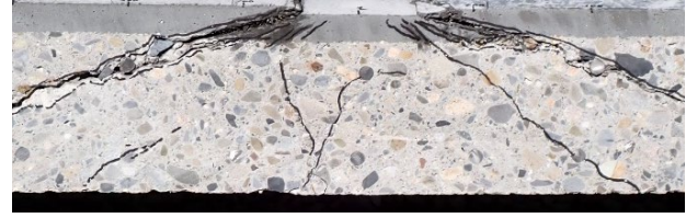
写真-5 載荷点近傍のひび割れ状況 (供試体-3: 橋軸直角方向断面)
