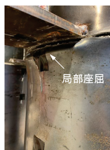
(c) 外鋼管の局部座屈
