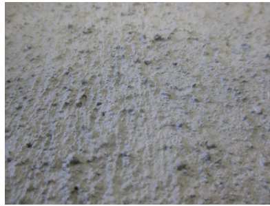
写真-2 水平ひび割れの表面状態
