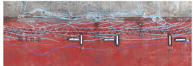
写真-4 施工目地部のひび割れ状況
