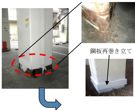
図-1 鋼板巻き補強柱の腐食部と対策工
