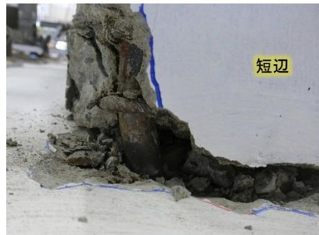
写真-2 座屈拘束鋼管のダウエル変形 (No.2)
