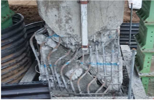
図－６ 起点方右側柱(コンクリート片撤去後)
