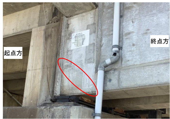
図-6 PC 桁の損傷状況
