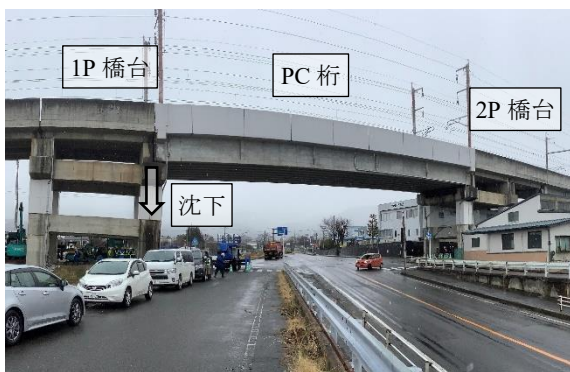
図-1 被害が生じた構造物の全景
