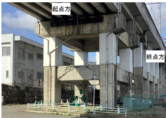
図-5 2P 橋台の損傷状況
